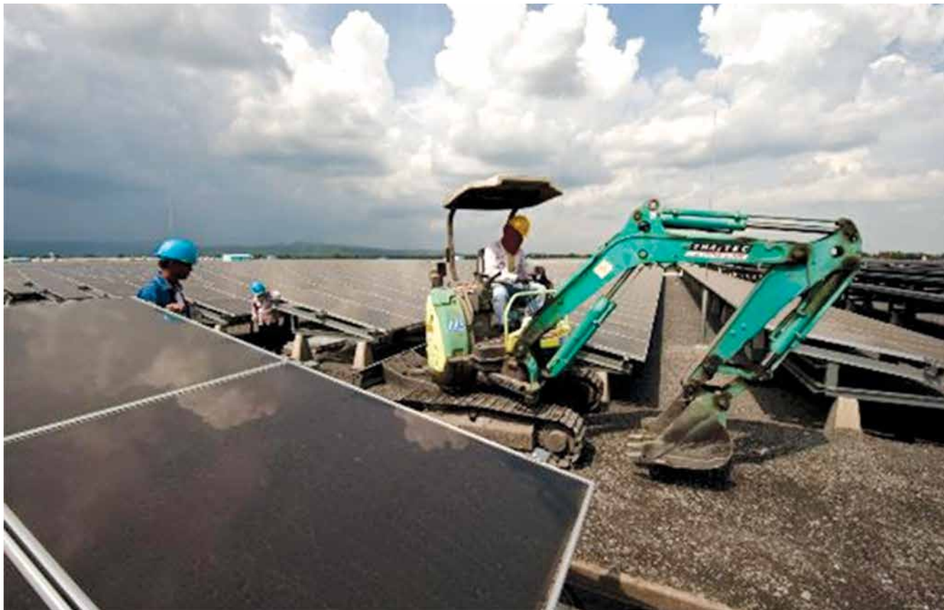
ภาพที่ 10: โครงการพลังงานแสงอาทิตย์ในประเทศไทย ลพบุรี โซล่าฟาร์ม ขนาด 73 เมกะวัตต์เป็นหนึ่งในโครงการผลิตไฟฟ้าโซลาร์เซลล์ที่ใหญ่ที่สุดในโลก โซล่าฟาร์มลพบุรีเป็นส่วนหนึ่งของความพยายามของประเทศไทยในการสร้างพลังงานจากแหล่งพลังงานหมุนเวียน
