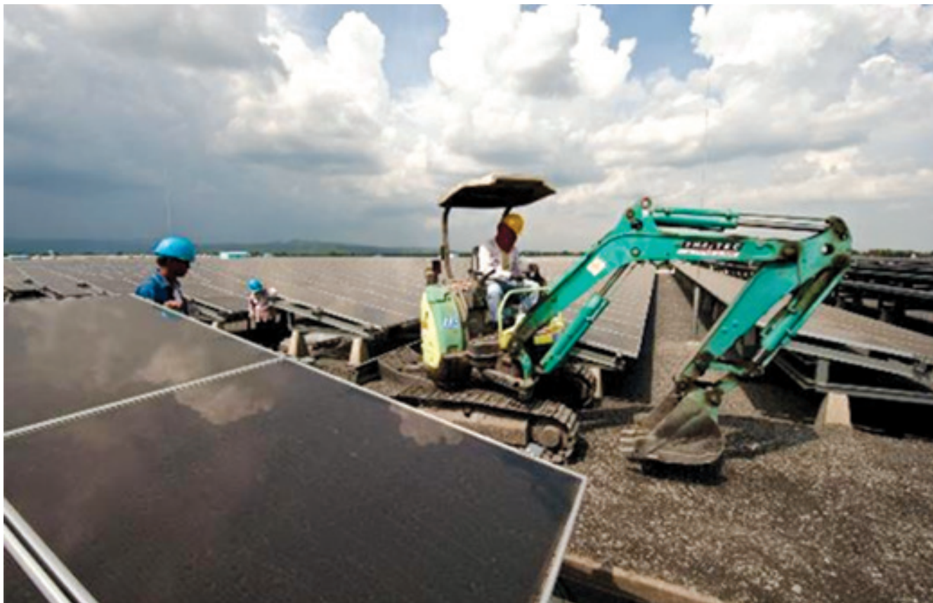
Рис. 10: Проект солнечной энергетики в Таиланде. Солнечная ферма Лопбури мощностью 73 мегаватта - один из крупнейших фотоэлектрических проектов в мире. Солнечная ферма Лопбури является неотъемлемой частью усилий Таиланда по производству энергии из возобновляемых источников. Автор: Азиатский банк развития (CC BY-NC-ND 2.0)
